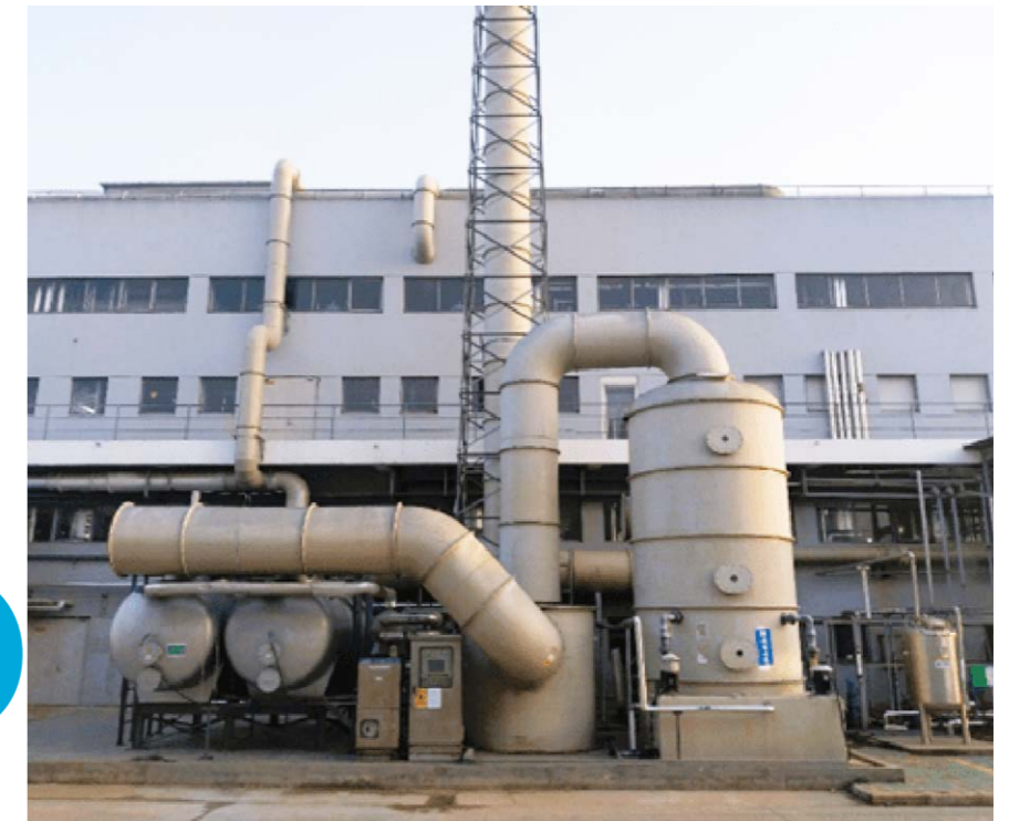
废气设施升级项目
